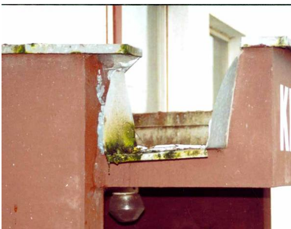
fot. 24. Blacha ocynkowana.
