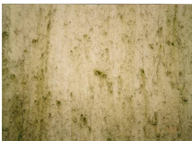
fot. 40. „kornik” – zbliżenie struktury.
