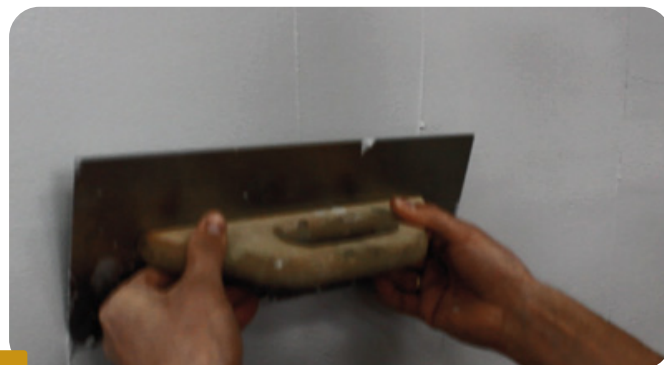
Fot.1. NAKŁADANIE MASY BOLIX TR W KOLORZE 38E ZA POMOCĄ PACY STAŁOWEJ.
