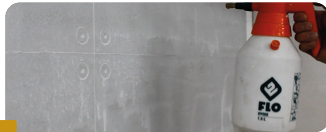
Fot.7. WYKONANIE ZACIEKÓW ZA POMOCĄ WODY ZE SPRYSKIWACZA..
